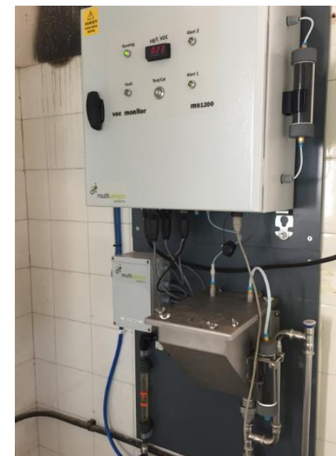
Photo de l'unité installée dans une dépendance à côté du forage.
