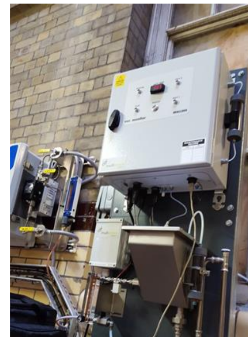
Le MS1200 installé sur site
