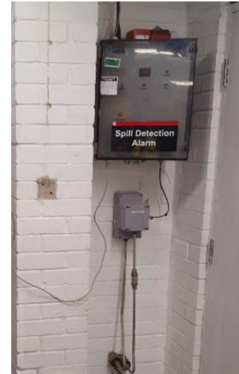
Photo de l'unité installée dans l'usine de fabrication
