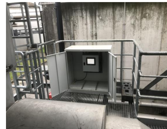
Photo de l'unité installée dans l'armoire pour une protection supplémentaire contre les intempéries.
