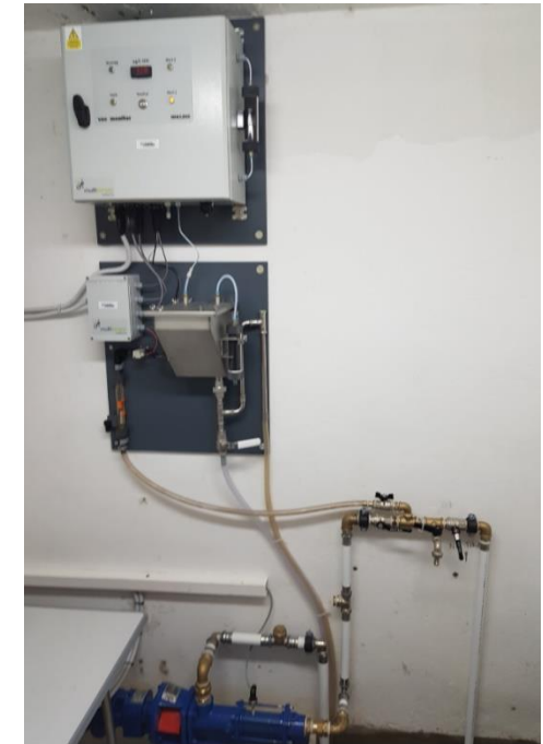
Une photo de l'unité installée dans la dépendance.
